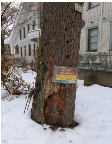
図 1. 注意喚起看板を設置した樹木 開口空洞、腐朽、穿孔がある。
